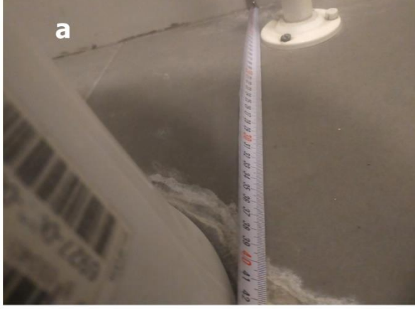
a- Klozet ile Duvar Arası ölçü 40 cm
